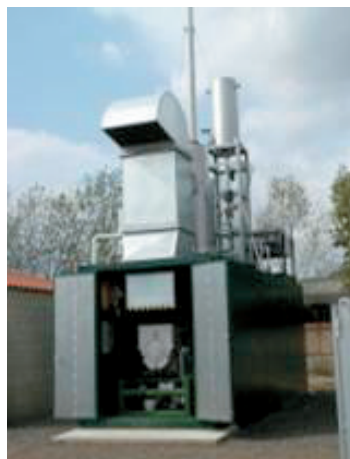
バイオガスエンジン発電装置
