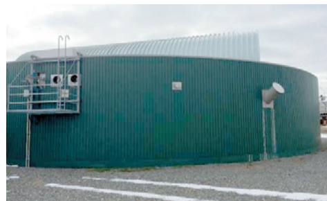
嫌気性消化発酵槽
